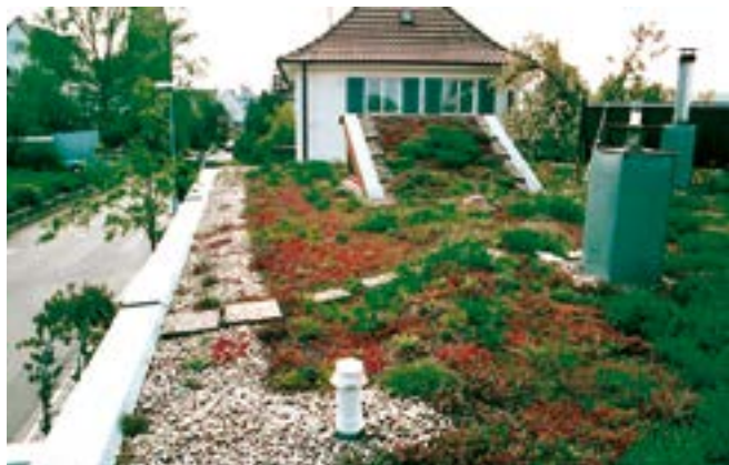
Fig. 36: Strisce di ghiaia sul bordo del tetto e su elementi emergenti del tetto.
