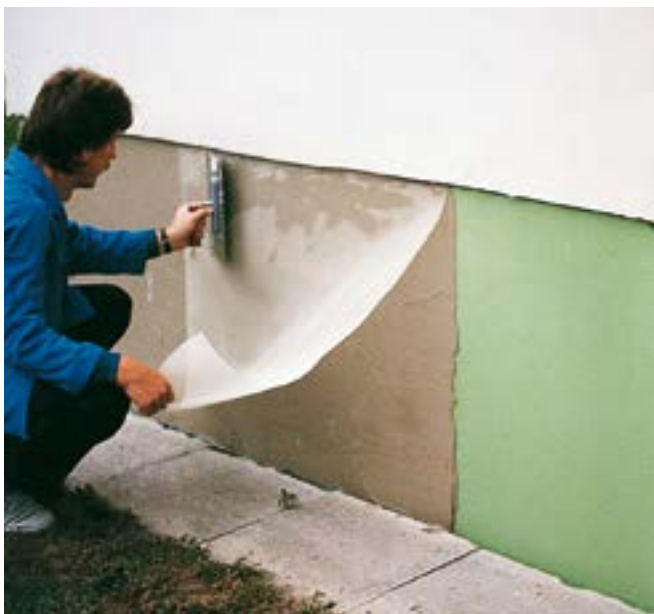
Fig. 26: Inserimento della rete in fibra di vetro nell'intonaco di fondo dello strato isolante dello zoccolo.
