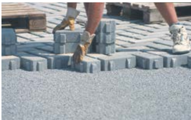
Fig. 39: Tetto rovescio a terrazza con Styrodur®. Posa delle lastre di calcestruzzo su letto di pietrisco.
